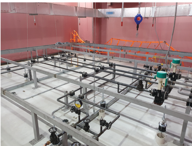
삼성바이오로직스 4차 콜드룸 냉동실 2실 콜드룸 19실 UNIT COOLER 94 SET CONDENSING UNIT 2 SET GLYCOL CHILLER 3 SET
