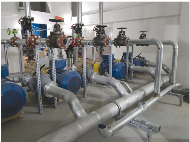
기계실 소방 기계실 부스터펌프 기계실 제연덕트 기계실
