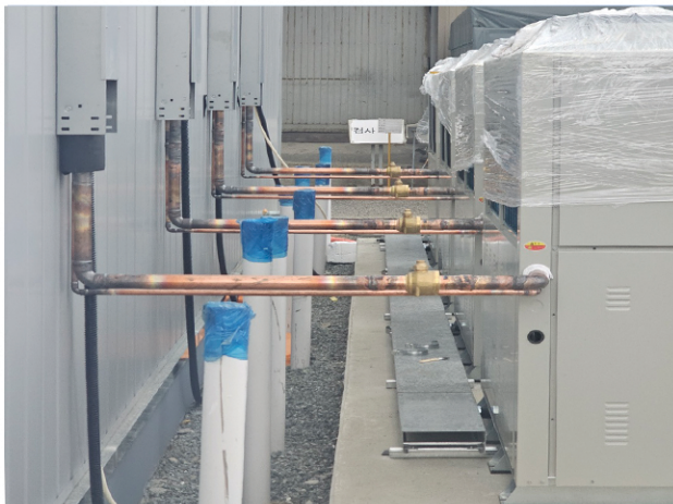
대한항공 테크센터 복합재 냉동창고 항공 소재 보관 냉동창고 UNIT COOLER 4 SET 공냉식 4 SET
