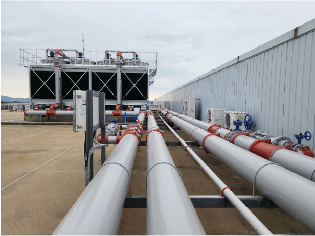
대한항공 인천 화물청사 냉각탑 흡수식 냉동기 펌프 열교환기
