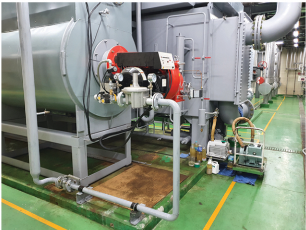
현대기아자동차(양재사옥) 대형보일러 성림산업 대형보일러 JTRI 케이스케이프 보일러(병렬식 보일러)
