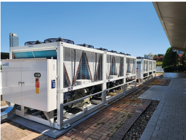
인천테크노파크 냉동기 펌프 열교환기
